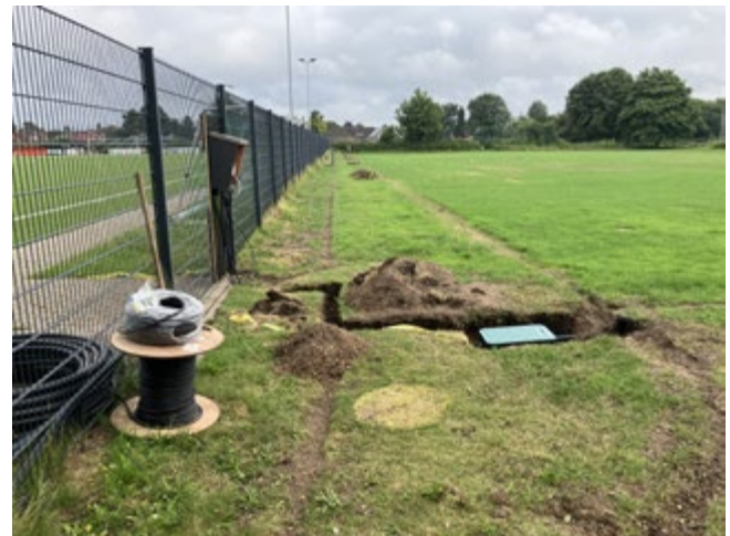
Auf Platz 3 ist während der Sommerpause eine Berieselungsanlage installiert worden, um eine gleichmäßige Bewässerung zu erzielen. Sie wird über eine App automatisch gesteuert.
